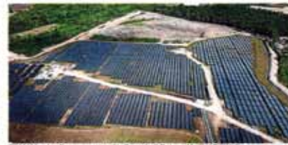
TAMAN solar 8 megawatt milik Cypark di Pajang, Negeri Sembilan.
